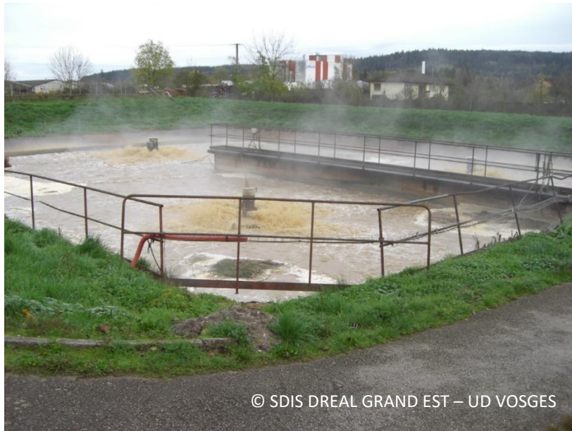
ARIA 54902 – Rejet de soude dans les eaux usées d'une fromagerie
