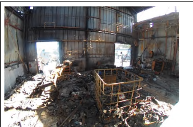
Photographie 14 : vue des deux entrées du local DDD. A gauche la zone du départ de l'incendie.
