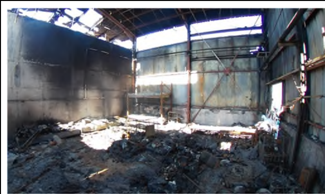
Photographie 12 : vue du local DDD après l'incendie
